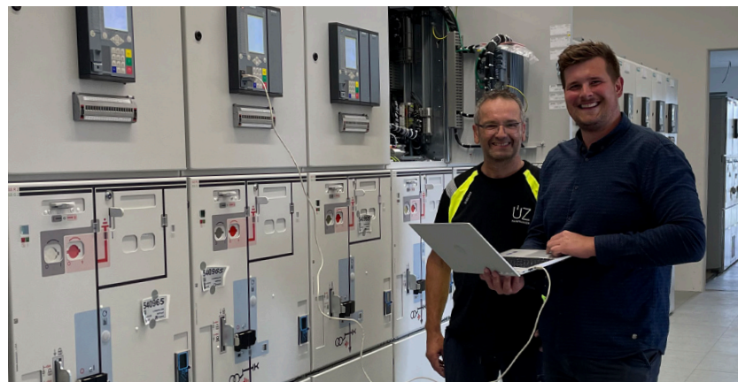
ÜZ-Mitarbeiter testen die modernen Anlagen im neuen Schalthaus.
