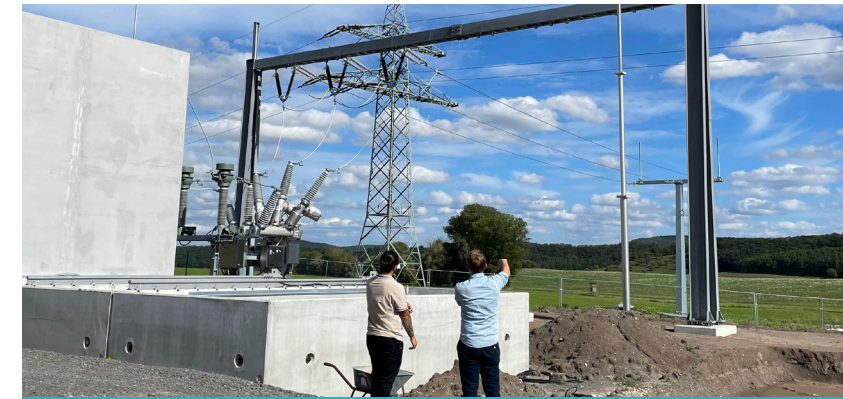
Die 30 MW-Anlage in Großbardorf benötigt ein eigenes Umspannwerk.
